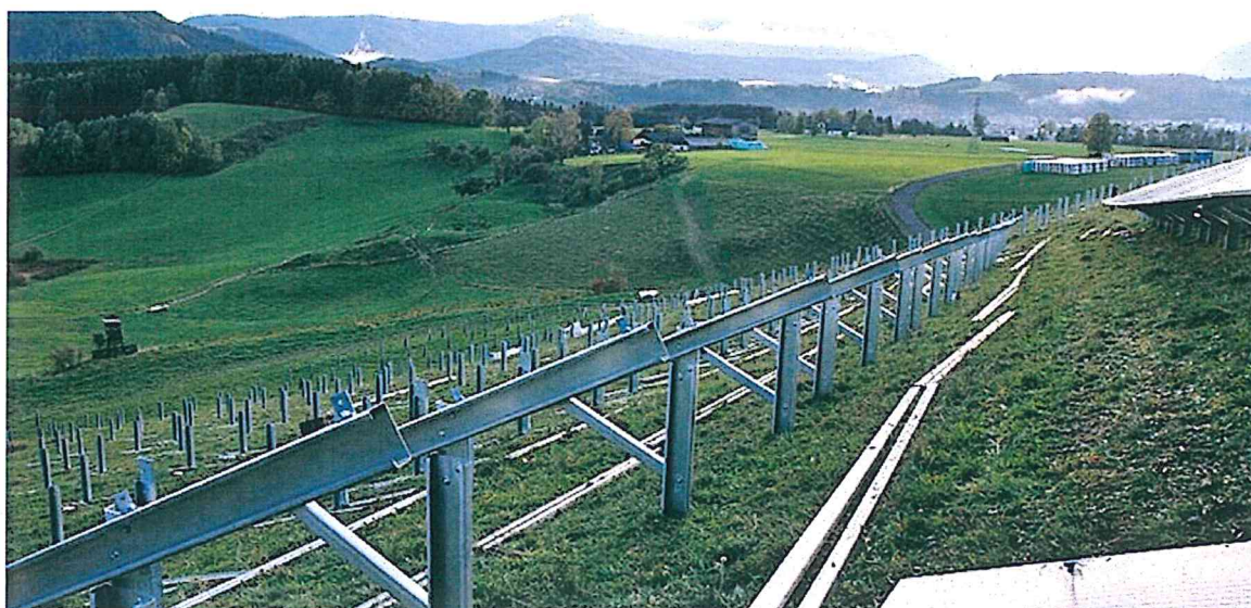
Zdjęcie 3. Konstrukcja przeznaczona do posadowienia paneli fotowoltaicznych.
