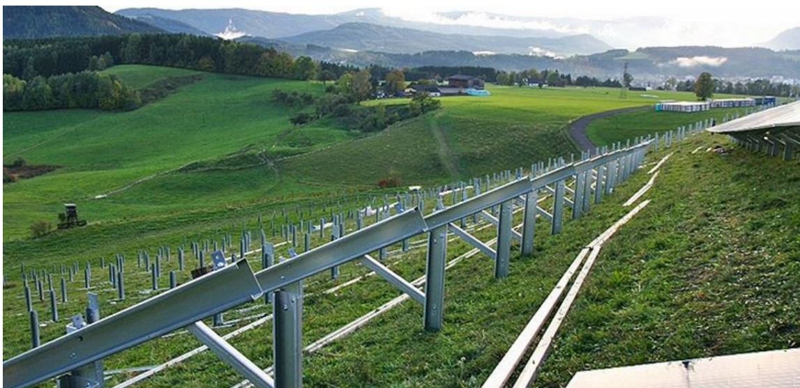
Zdjęcie 3. Konstrukcja przeznaczona do posadowienia paneli fotowoltaicznych.
